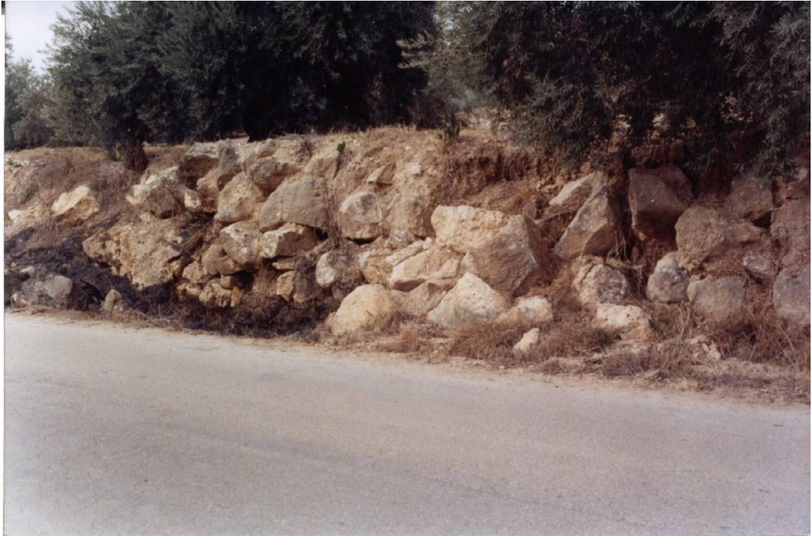
Instantánea con los restos de la muralla desmoronada en el margen izquierdo de la carretera.
